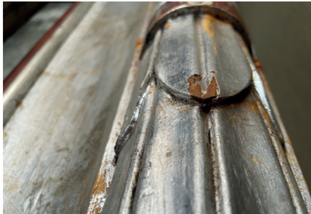
Jedno z mnohých poškození rámu.
